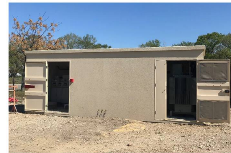
Figure 5 : Photo d'un poste électrique similaire (Valeco)
